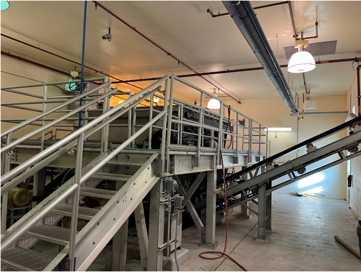
EXISTING BELT PRESS LOS ALAMOS
